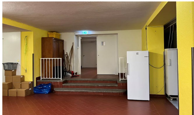
Halle UG, fehlende Lagerräume
